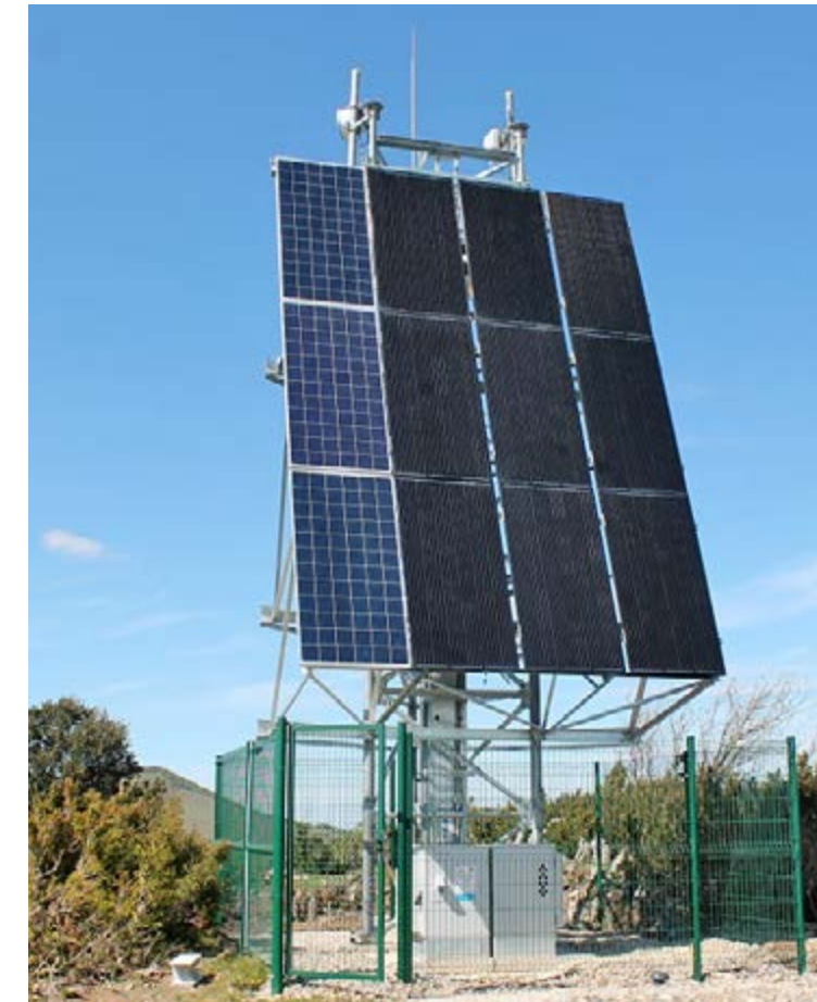
El uso de la energía solar ofrece la flexibilidad de instalar un repetidor en la ubicación correcta en Francia.
