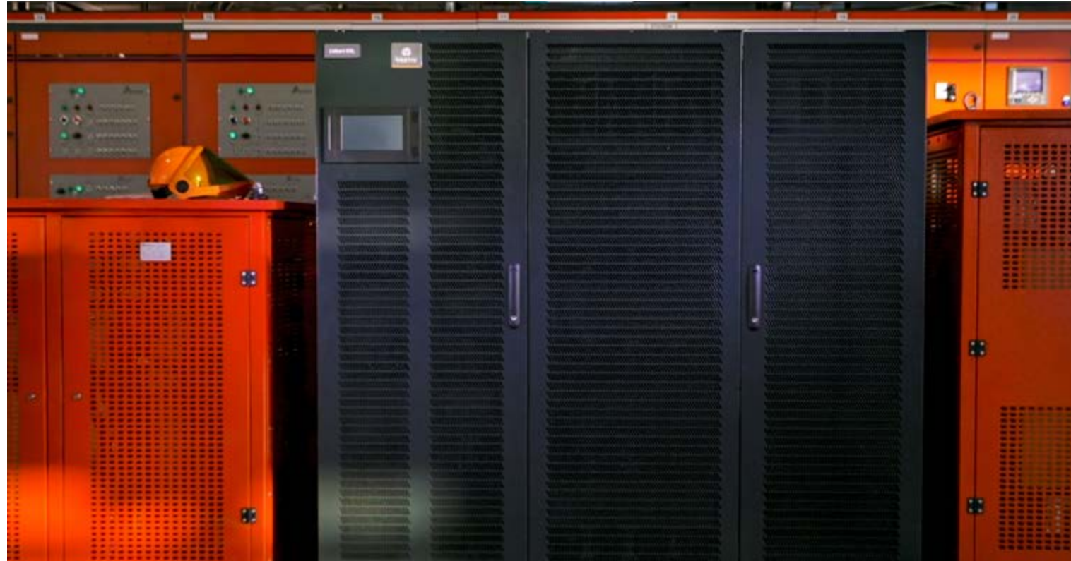
Una prueba de aceptación de fábrica de un UPS Vertiv™ Liebert® EXL S1 en el centro de experiencia para clientes de Castel Guelfo di Bologna, Italia.
