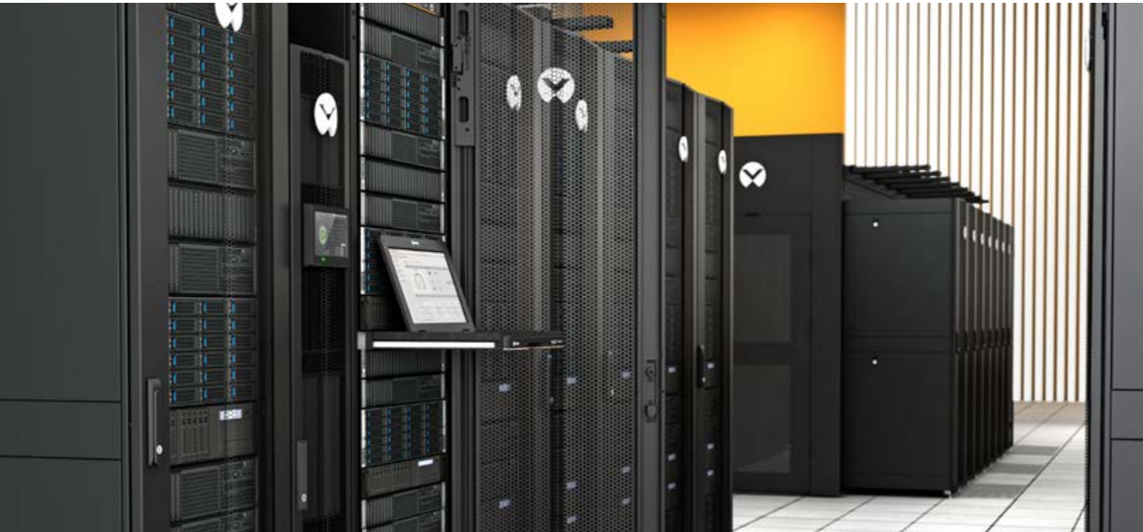
Los sistemas de contención de pasillos Vertiv™ reducen el consumo energético del enfriamiento hasta en un 40 %.
