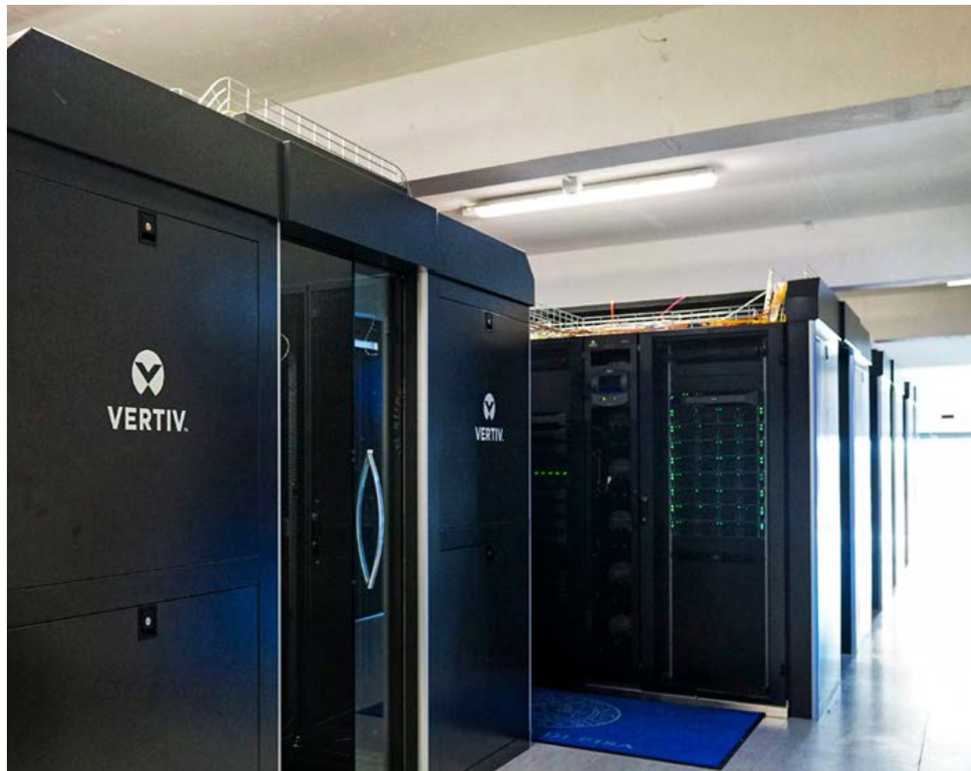
L'Université de Pise utilise les solutions à haute densité de Vertiv, y compris le refroidissement liquide pour les applications directes-sur-puce et les systèmes d'alimentation à haute densité, pour l'extension de son Hybrid Green Data Center.
