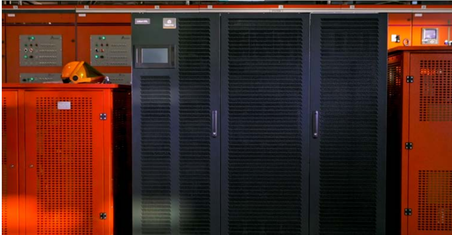
Une ASI Vertiv™ Liebert® EXL S1 subit des tests d'acceptation en usine au centre d'expérience client de Castel Guelfo à Bologne, Italie.
