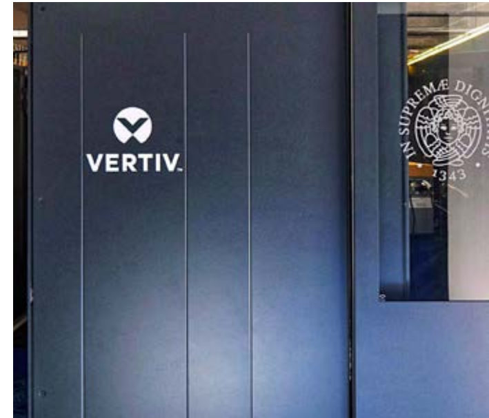
L'un des principaux avantages fournis par les solutions Vertiv est la mise en œuvre du refroidissement liquide dans les data centers existants refroidis par air.
